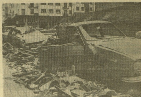
La estructura metálica del Instituto Nacional de Investigación Médica de Irún está por los aires, yendo a caer sobre estos vehículos aparcados, a los que materialmente machacó. (Foto GARCÍA)
