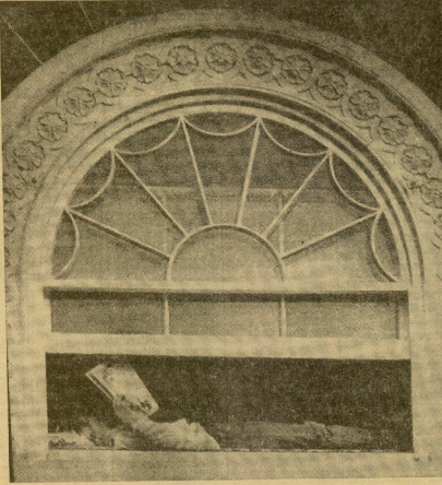
El arco de la iglesia de San Juan de los Rios, en Albaladejo, se derrumbó el día 10 de marzo. El arco de la iglesia de San Juan de los Rios, en Albaladejo, se derrumbó el día 10 de marzo. El arco de la iglesia de San Juan de los Rios, en Albaladejo, se derrumbó el día 10 de marzo.
