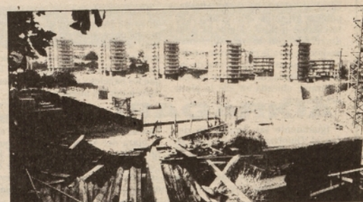
Las obras de Miraconcha Sur fueron paralizadas por no cumplir con los requisitos legales.
