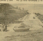
Desde aquí se inicia la nueva fase de la obra, o sea, desde el depósito de agua de Orlamendi al cruce de Galarreta.
